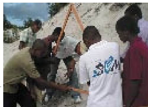
Formation d'un Comité de l'eau à l'utilisation d'un «triangle A» pour la création de courbes de niveau.
