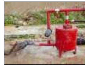
Filtre à sable modernisé
