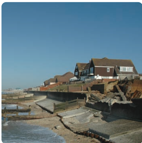
À gauche : Digues de protection abîmées, Selsey, Royaume-Uni À droite : Barrières de protection, Selsey, Royaume-Uni © Save Our Selsey
