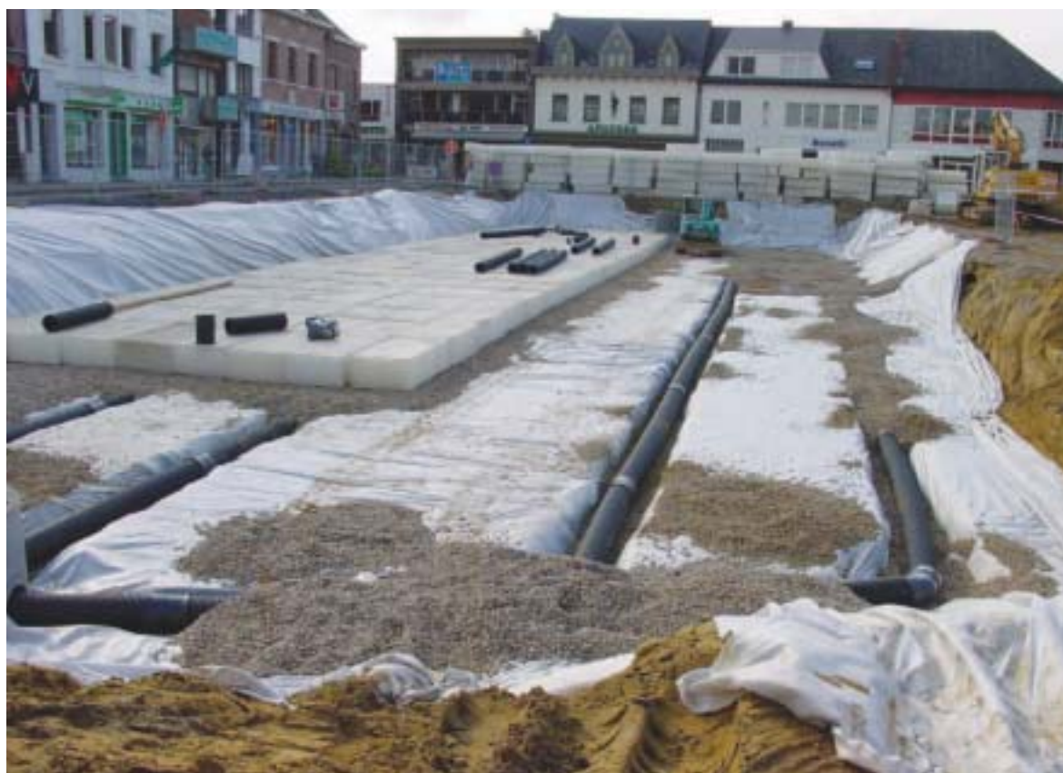
Haacht: ondergrondse infiltratievoorziening (drainagekoffers) met vertraagde afvoer van regenwater.
