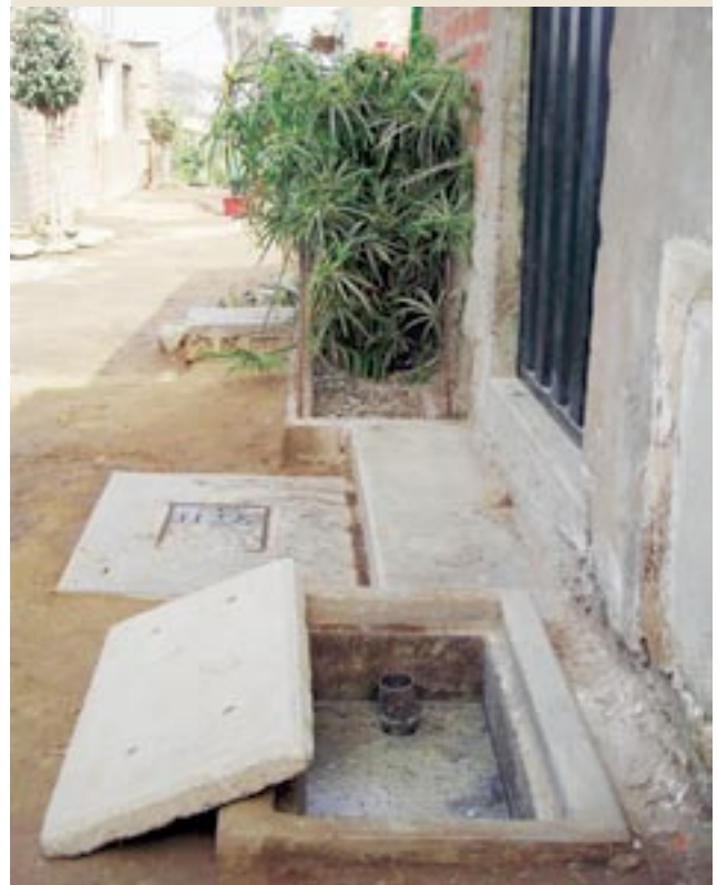
Foto 4: Sistema de tratamiento
