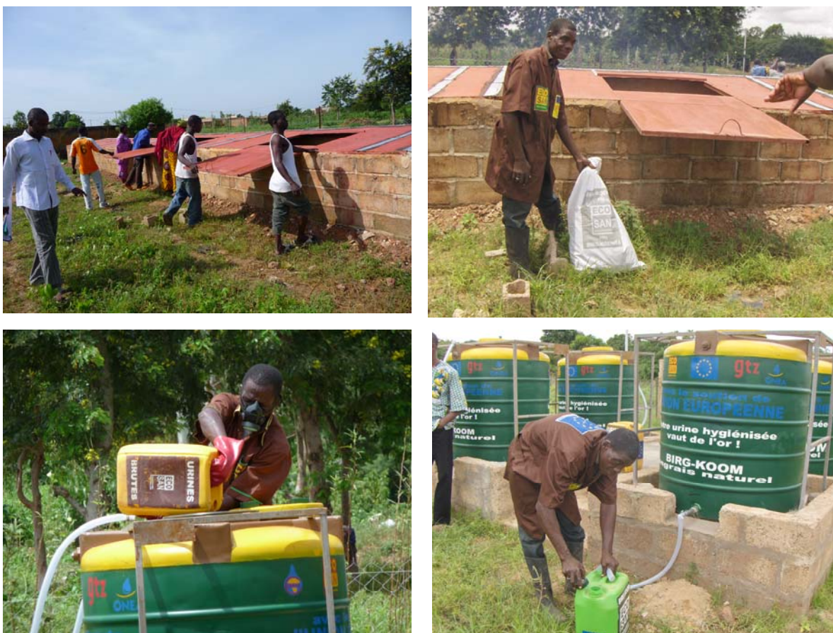
Photos 3 : installations du site d'hygiénisation
