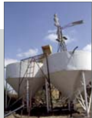
Cuves de décantation en fibre de verre
