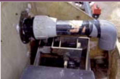
Dosificador de sulfato de alúmina
