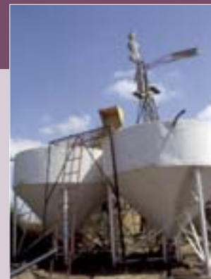
Cubas de decantación de fibra de vidrio
