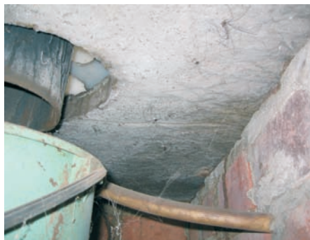
Photo 6-56 : Toiles d'araignées et araignées à l'intérieur de la fosse
