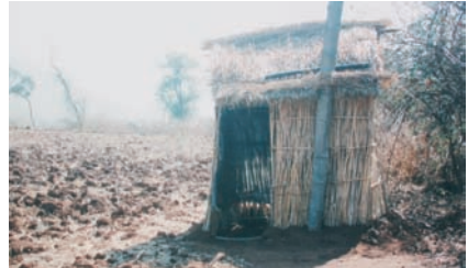
Photo 3-56 : Un autre type de structure avec un tuyau de ventilation.
