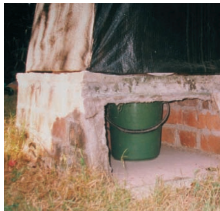
Photo 6-40 : Vue interne de la fosse avec le seau en plastique où sont collectées les fèces
