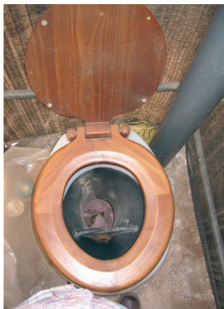
Photo 6-57 : Latrine à séparation d'urines nettoyée
