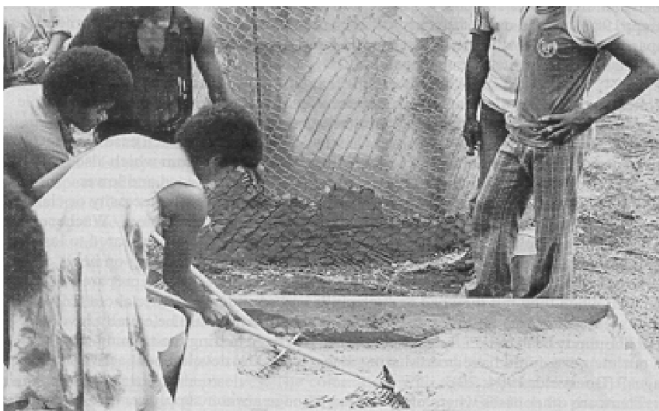
Schéma 12. Les projets de collecte des eaux pluviales, tels qu'ici à Tonga, tendaient à être ceux des femmes plutôt que des projets communs, avec groupes de femmes assurant toute la construction et le financement (Photo IRC par Akil Khan)
