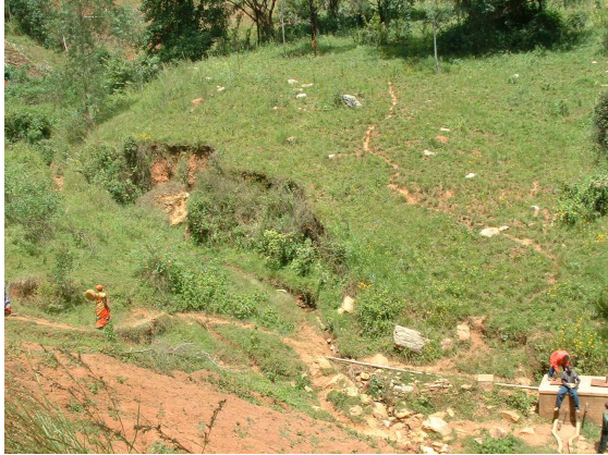
Zone de captage N°1 du réseau. La zone est non protégée et très menacée par l'érosion. Une partie importante des tuyaux a été emportée.
