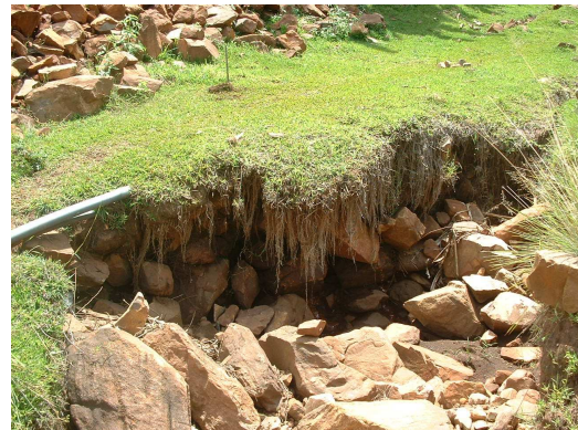
Deux tuyaux parallèles menacés par l'érosion dans la zone des captages.
