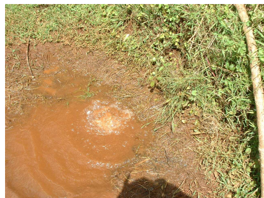
Fuite d'eau très importante en amont du réservoir n°3.
