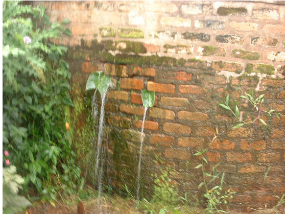
Fuite au niveau du grand réservoir de stockage dont la capacité a été estimée à 75 m 3 . Menace d'écroulement du réservoir.
